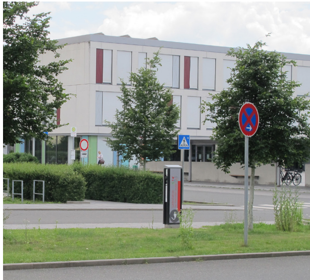
+ Ladesäule für Elektroautos
