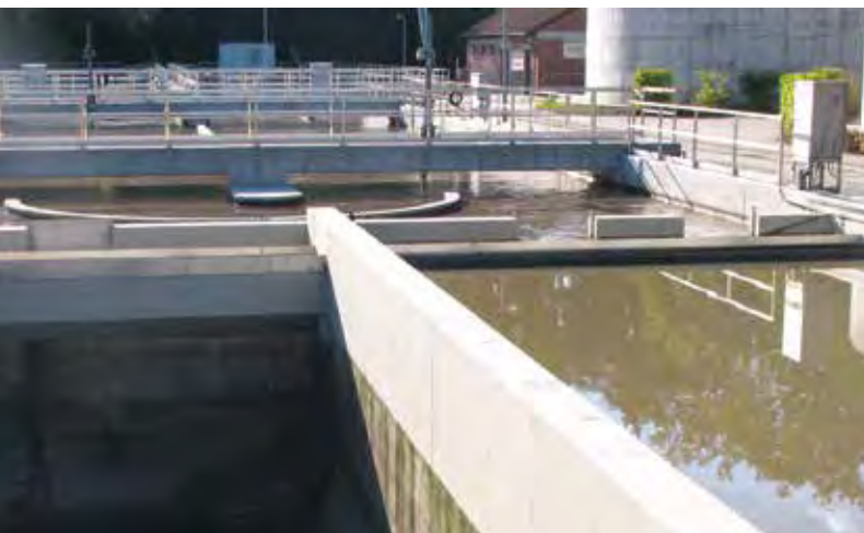
Kläranlage in Kleinschwarzenlohe © Markt Wendelstein
